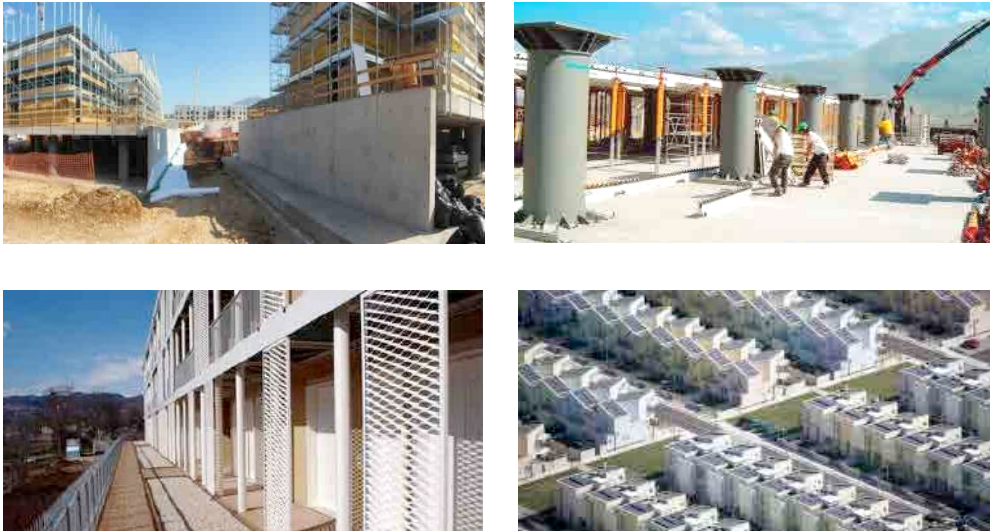
Figura 5.77 Panorámica de la obra del plano C.A.S.E. en el área de San Antonio.
