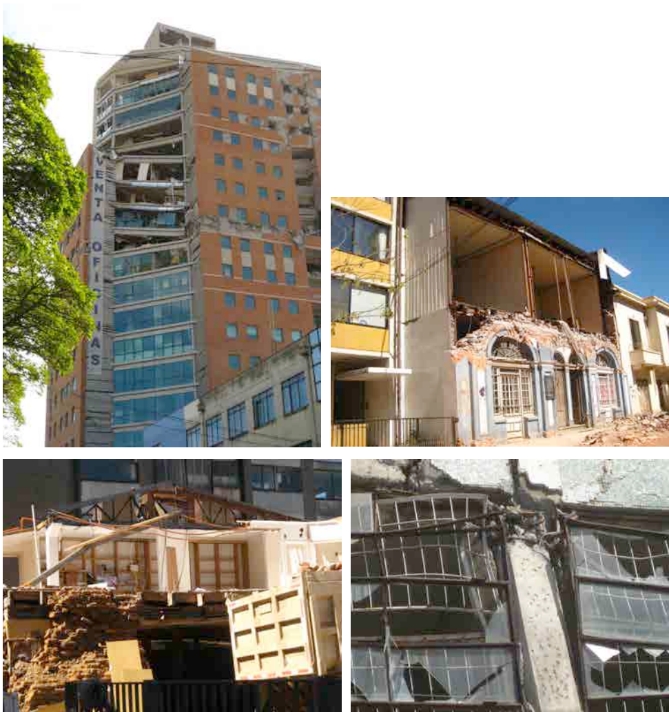
Figura 6.83-6.86 Edificios derrumbados en el centro de Concepcion - Fotos propias del autor
