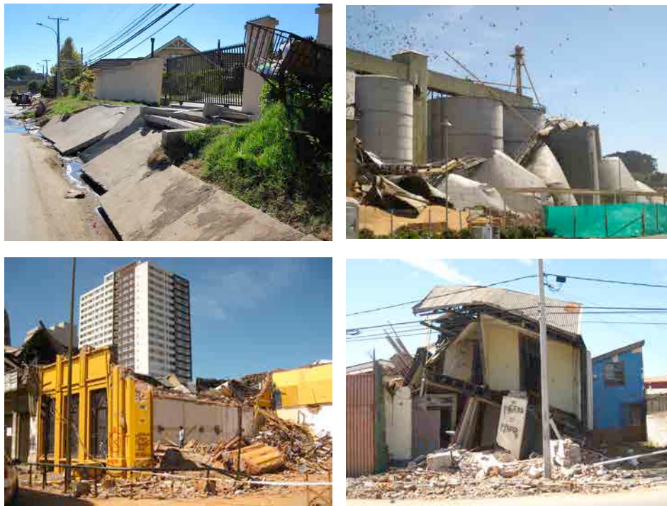
Figura 6.59-6.60 Calle levantada en Concepción y silos de molinera. Figura 6.61- 6.62 Edificios derrumbados en el centro de la ciudad de Concepción - Fotos propias del autor
