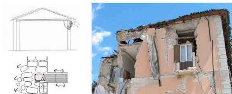
Figura 5.70 Abruzzo 2009 – Derrumbe de parte de mampostería en presencia de bordillos de de hormigón armado Fuente Governare
