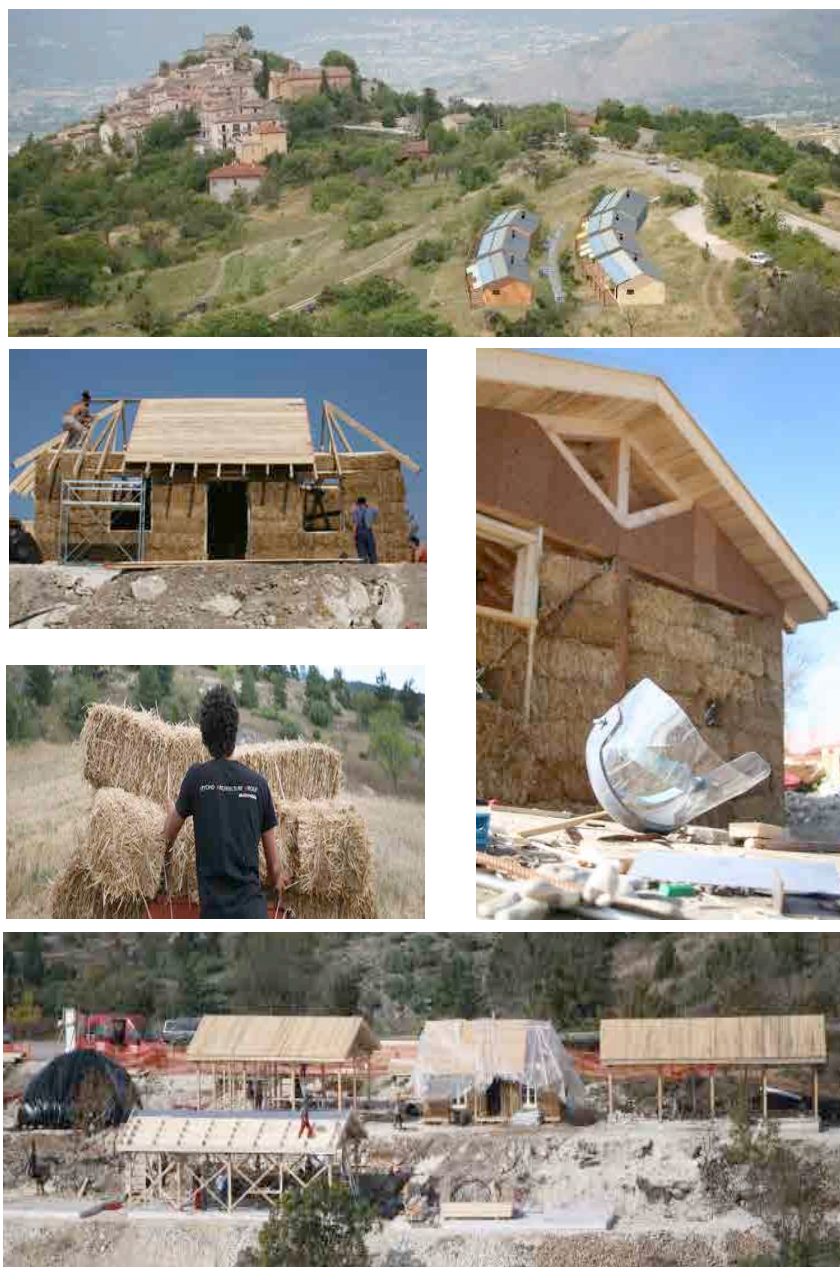
Figura 5.92 Fases de la construcción de las casas prefabricadas de Pescomaggiore. Fotos proporcionadas por BAG - Beyond Architecture Group
