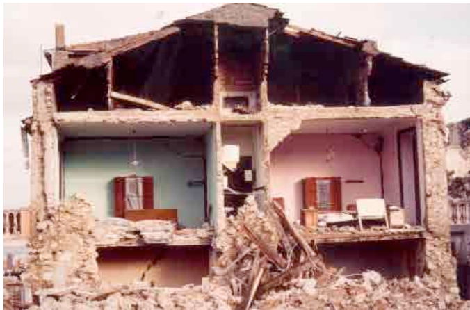
Figura 5.22 Casa derrumbada tras el terremoto de Irpinia, 1980.
