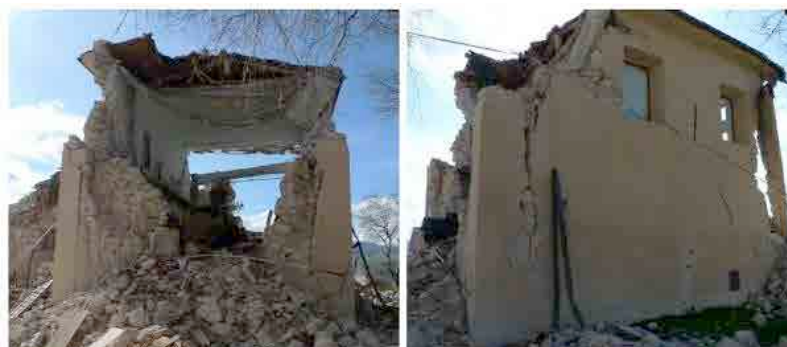
Figura 5.68-5.69 Colapso casa de ladrillos – Aquila 2009
