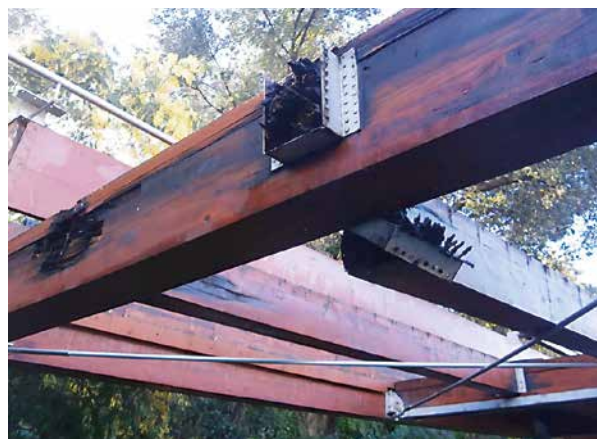
Figura 12. Pudrición de apoyos.
