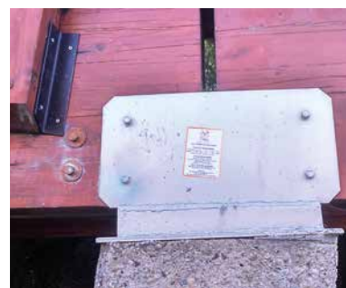
Figura 26. Los apoyos intermedios no evacuaban el agua.
