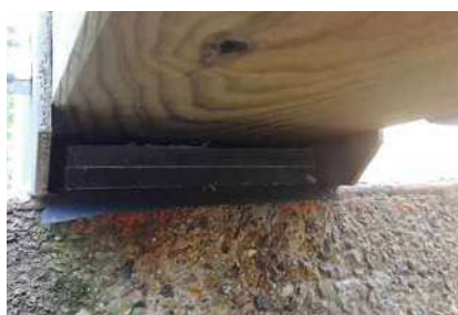
Figura 23. Placas de tresa en apoyo.
