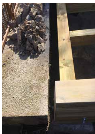
Figura 21. Separación de las jácenas del contacto directo con el terreno.
