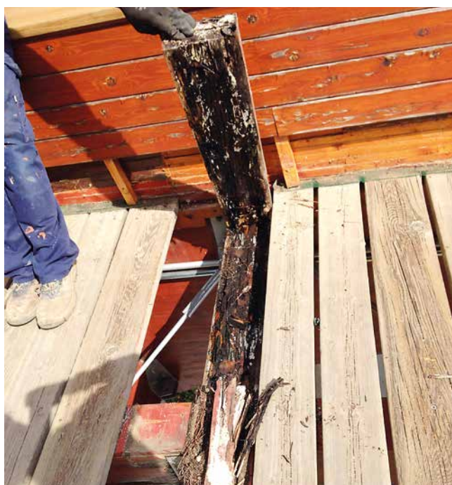
Figura 6. Pudrición en unión entre perfil de apoyo de latas y jácenas.
