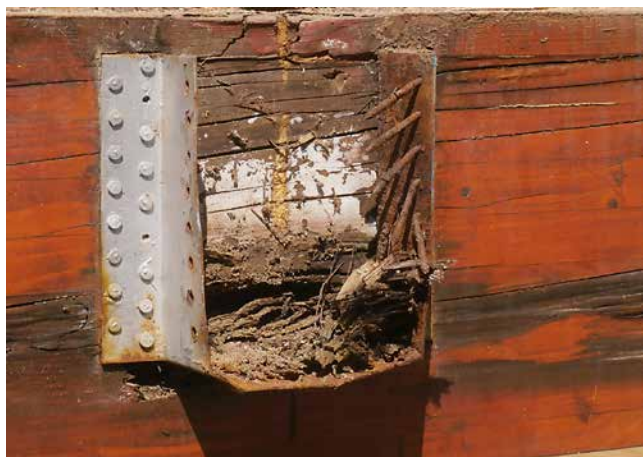
Figura 5. Pudrición en viguetas con latas superpuestas.
