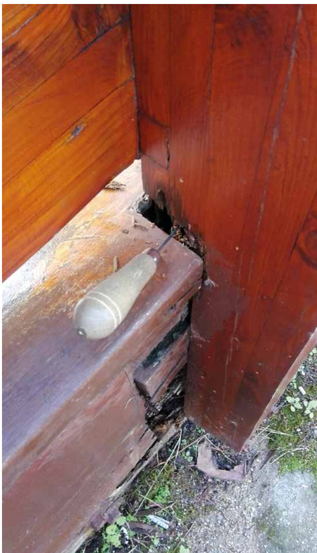
Figura 8. Pudrición en jácena principal, en contacto con montantes de barandilla.
