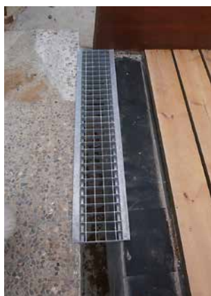
Figura 22. La misma separación facilitando el drenaje.
