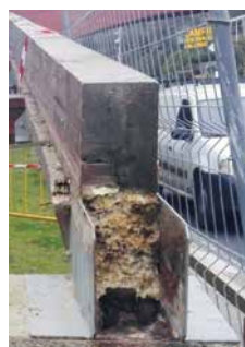
Figura 25. Pudrición de la jácena en los apoyos intermedios.
