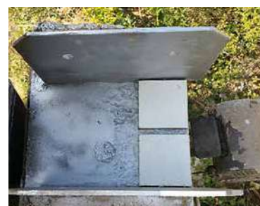
Figura 29. Separadores de tresa en apoyos intermedios.
