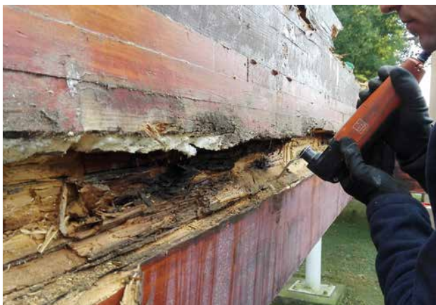
Figura 7. Pudrición en zona de anclaje de montante en vigas.
