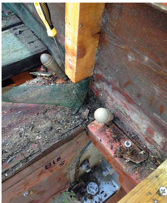
Figura 13. Pudrición de la jácena en la zona del rastrel de soporte.
