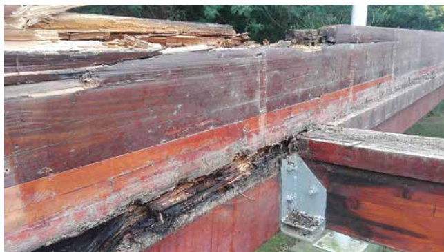
Figura 4. Pudrición en apoyos de viguetas y jácenas.
