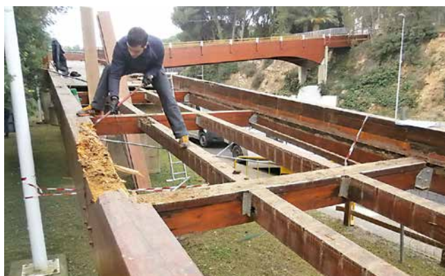
Figura 9. Apoyo de madera al terreno, con pudrición de jácenas principales.
