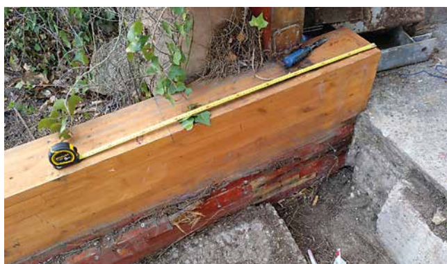
Figura 10. Pudrición de apoyo por contacto directo con el terreno.
