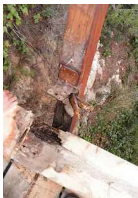
Figura 33. Pudrición de la jácena principal en contacto con los montantes de la barandilla.
