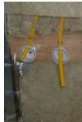
Elektroinstalacija vođena u sloju toplinske izolacije
