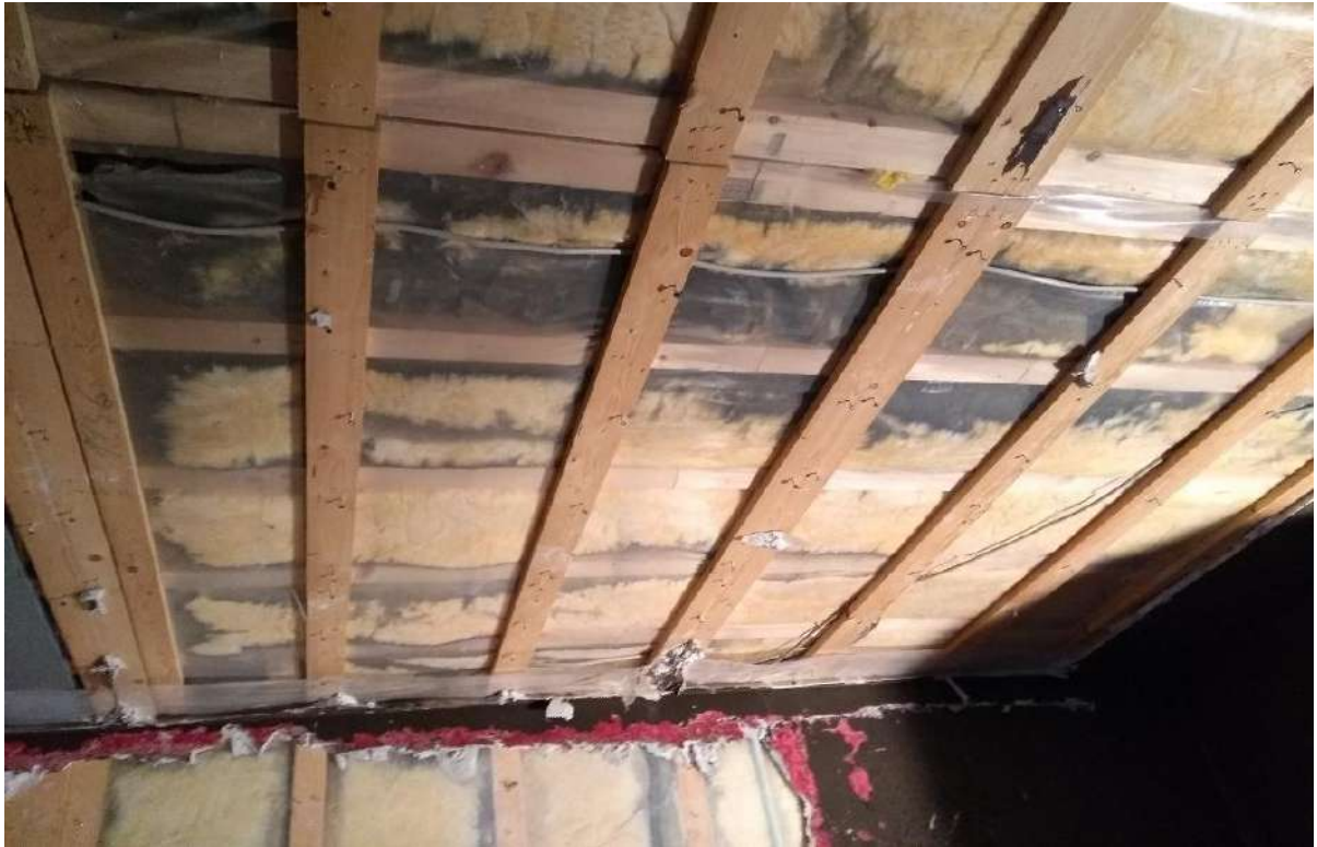
Abbildung 3: Decke über dem Brandherd nach Öffnen der Konstruktion
