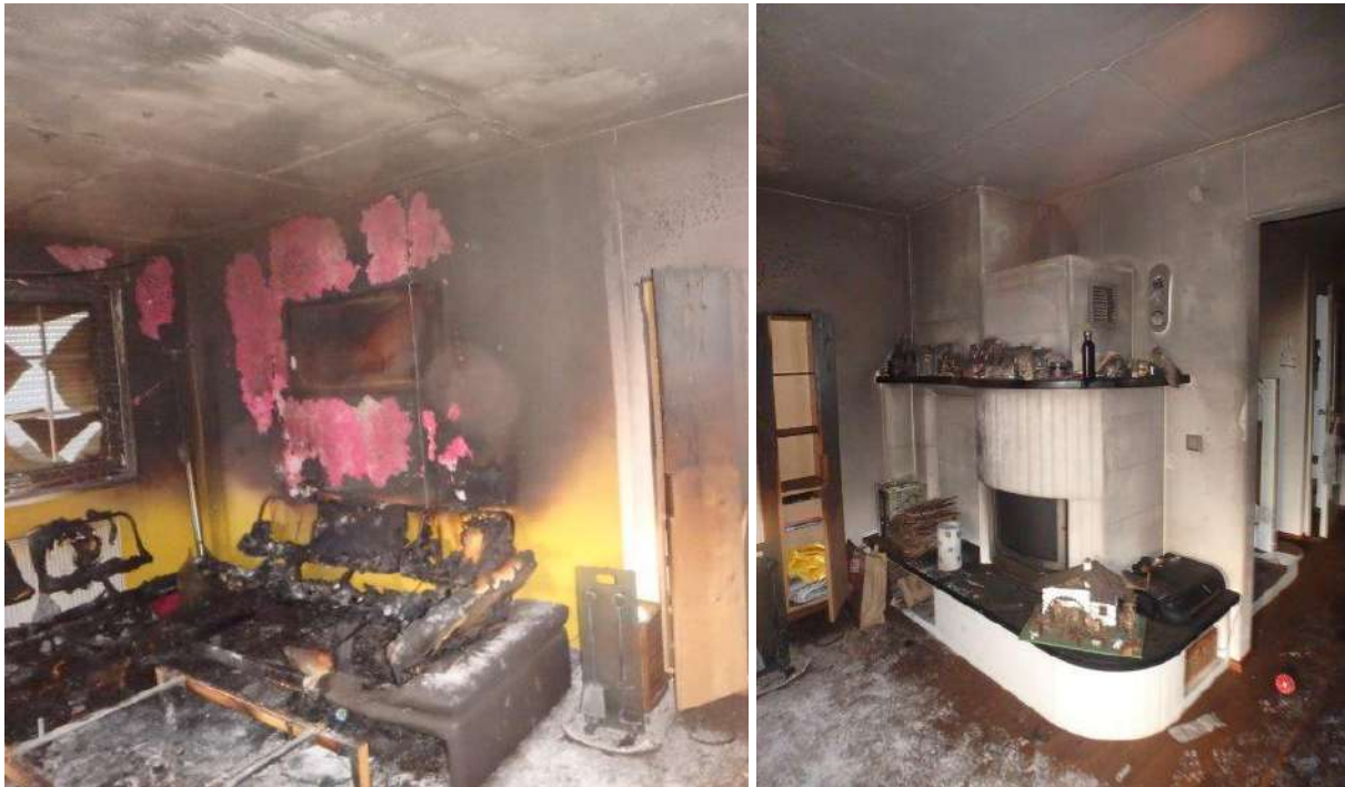
Abbildung 2: Brandherd mit starker Rußbeaufschlagung auch in angrenzende Räumlichkeiten
