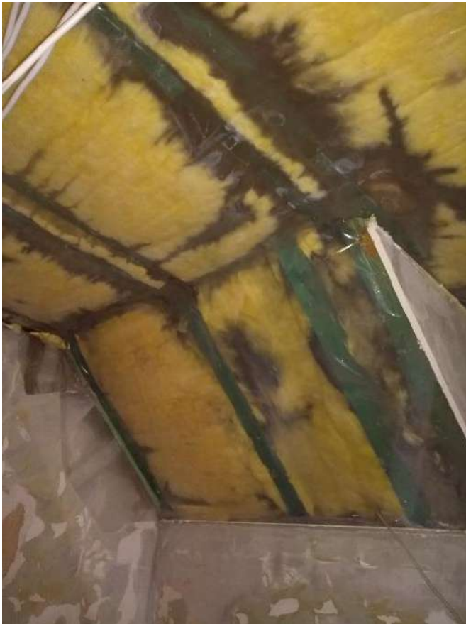
Abbildung 5: Rußbeaufschlagung im Bereich der Dämmebene in der Dachschräge hinter der Gipsbeplankung und Dampfbremse
