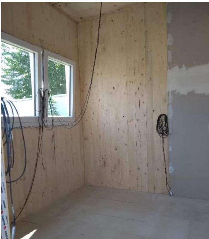
Abbildung 11: Brettsperrholzkubus-Inneraum: oben: nach dem Brandereignis und dem Löschen; unten: nach fertiggestellter Sanierung
