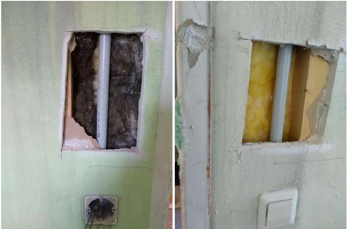
Abbildung 4: Öffnen der Konstruktion im Bereich von elektrischen Leitungen mit unterschiedlicher Verschmutzung
